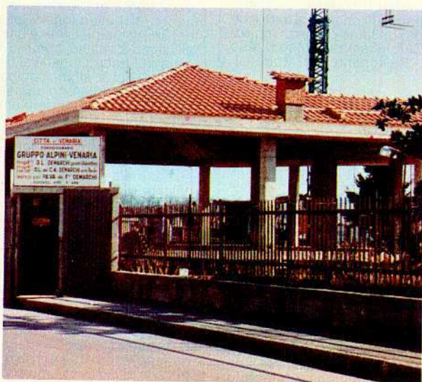
CASA DEGLI ALPINI - GRUPPO DI VENARIA - SEZIONE DI TORINO - Il gruppo alpini di Venaria sta facendo le cose in grande come si può vedere dalla fotografia che riproduce l'imponente nuova sede in costruzione.
