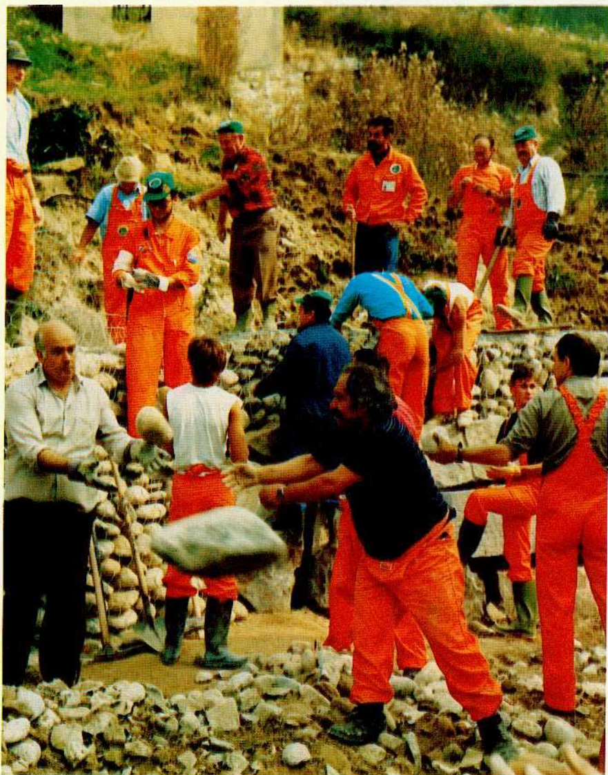
Intervento degli alpini della Protezione Civile su un movimento franoso che minacciava una comunità per il recupero dei tossicodipendenti, a Credaro (BG). Le foto mostrano: la collina prima dell'intervento (pag. 6); fasi di lavoro; il lavoro terminato (pag. 8).
